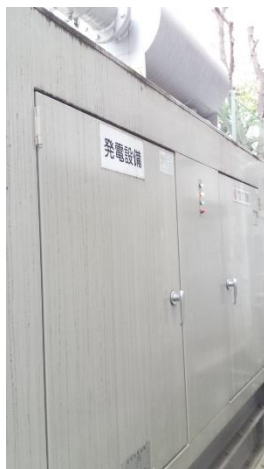
自家発電装置
