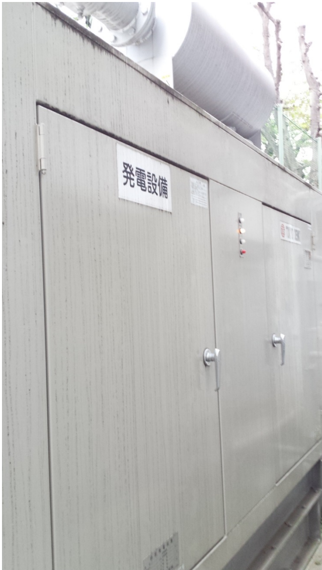
自家発電装置
